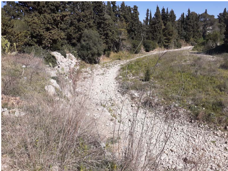
Figura 7: Riu Foix aigües amunt del punt on es preveu el final de l'endegament. Al marge dret del riu es veu un mur d'escullera. S'intueix el fonament a una cota superior al de la llera.
